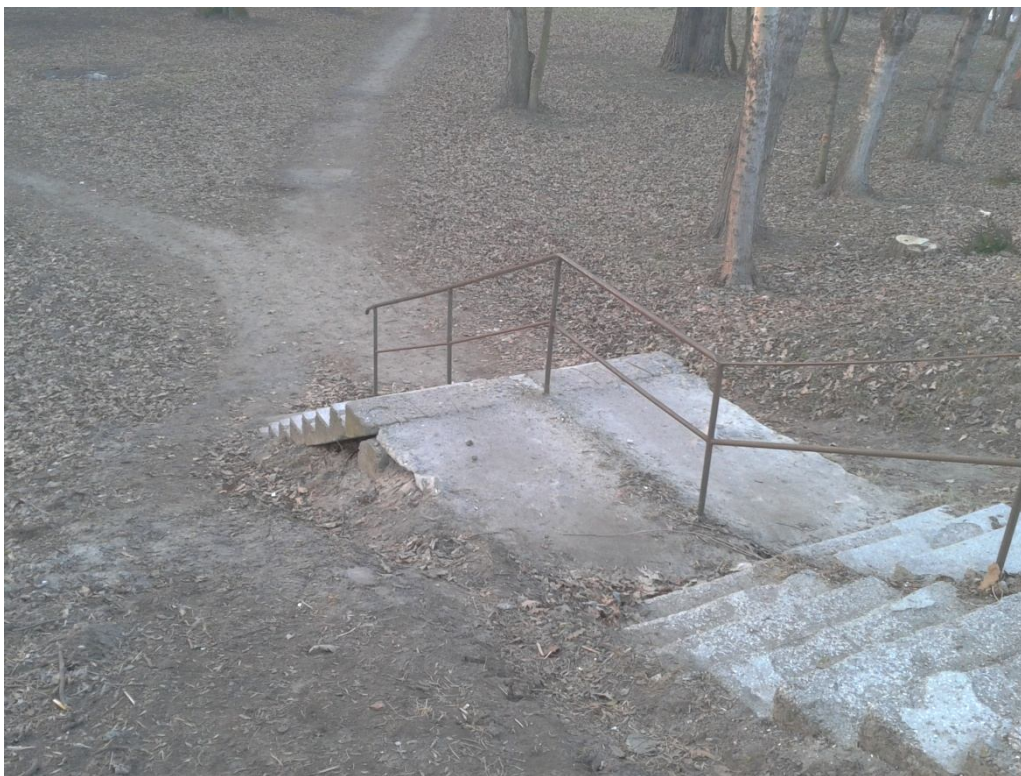
Zdjęcia przedstawiają stan techniczny schodów
